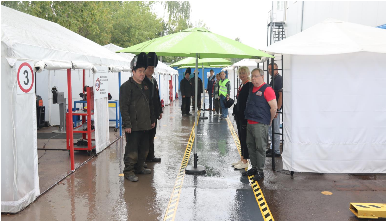
Проведение практического этапа профессионального экзамена путем сварки контрольных сварных соединений (КСС) в инвентарных укрытиях (сварочные палатки) на открытой производственной площадке «Испытательного центра»
