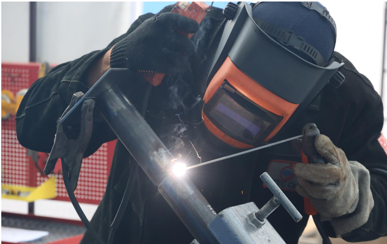
Ручная дуговая сварка (РД, 111) электродами с кислорутитовым покрытием марки ОК 61.30 (ESAB, Швеция) классификации E308L-17 по AWS A5.4 кольцевого стыкового соединения труб (патрубки) Ø 57×5,0 мм из стали 09Г2С, Ø 57×5,0 мм из стали 12Х18Н10Т в наклонном положении (труба неповоротная) сварка снизу-вверх (Н-Л045) под углом 45°
