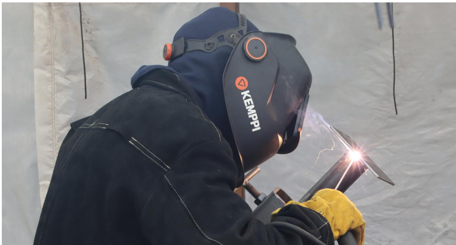
Ручная дуговая сварка (РД, 111) электродами с кислорутитовым покрытием марки ОК 61.30 (ESAB, Швеция) классификации E308L-17 по AWS A5.4 таврового соединения трубы (патрубок) Ø 57×5,0 мм из стали 12Х18Н10Т с пластиной 150×150×5,0 мм из стали СтЗсп в наклонном положении (труба неповоротная) сварка снизу-вверх (Н-Л045) под углом 45°
